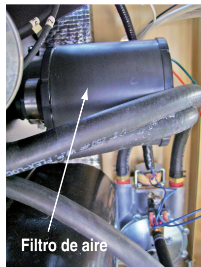
Figura 4.6 — Limpiador de aire del motor de 10kW
